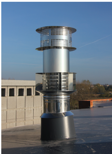
Završni dio dimovodnog sistema CLV.
